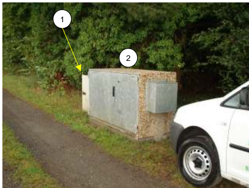
Fertigteil-Stationsschrank (2), Stromversorgung (1); Bild 07
