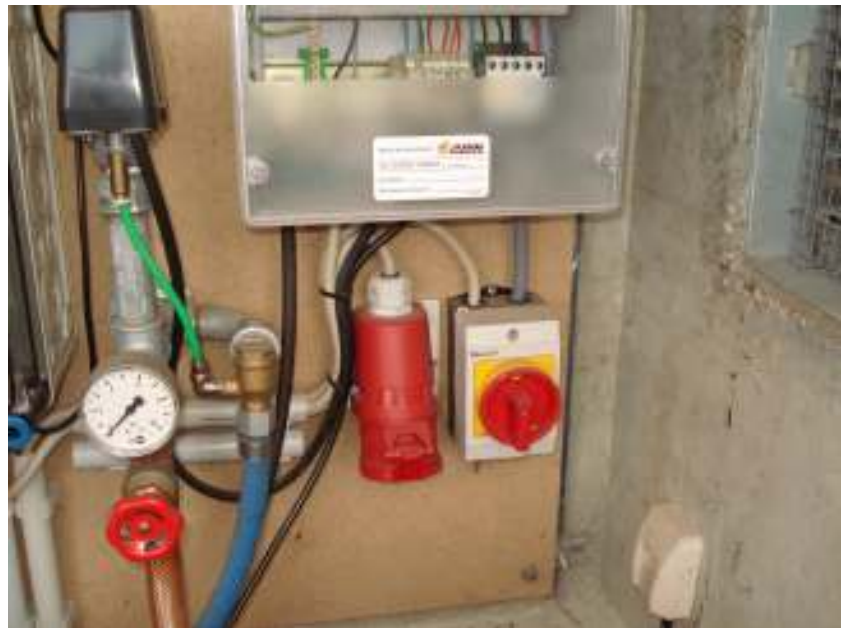
Hauptschalter, Kraftstromanschluss; Bild 10
