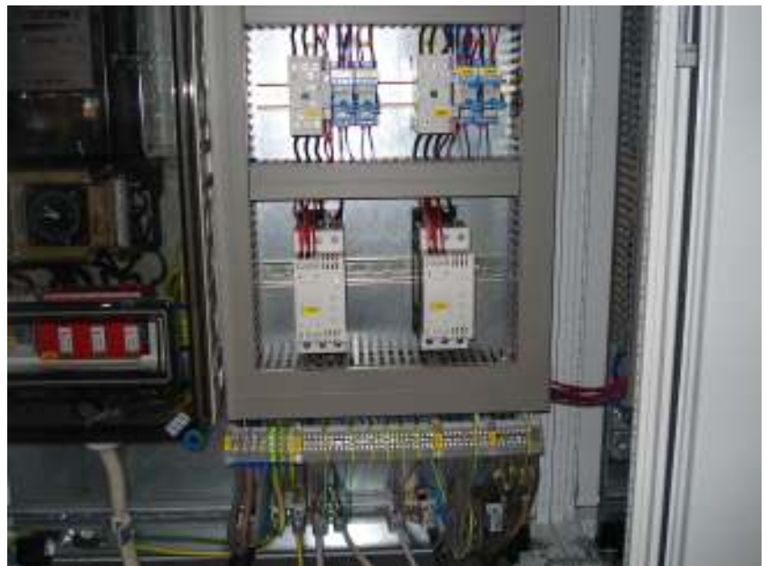
Schaltschrank rechtes unteres Schaltfeld; Bild 36
