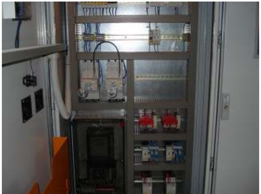
Schaltschrank linkes unteres Schaltfeld; Bild 34
