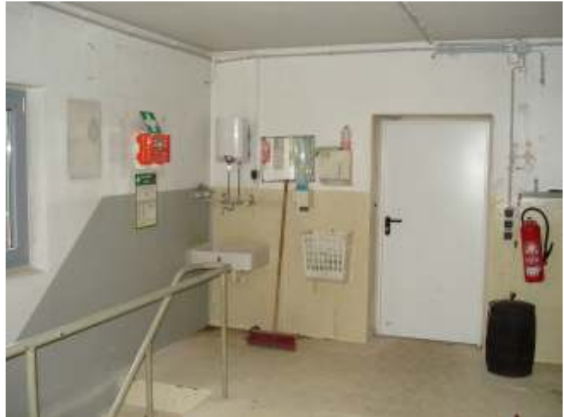
Eingangsbereich, Waschgelegenheit, Abgang Pumpenkeller; Bild 30
