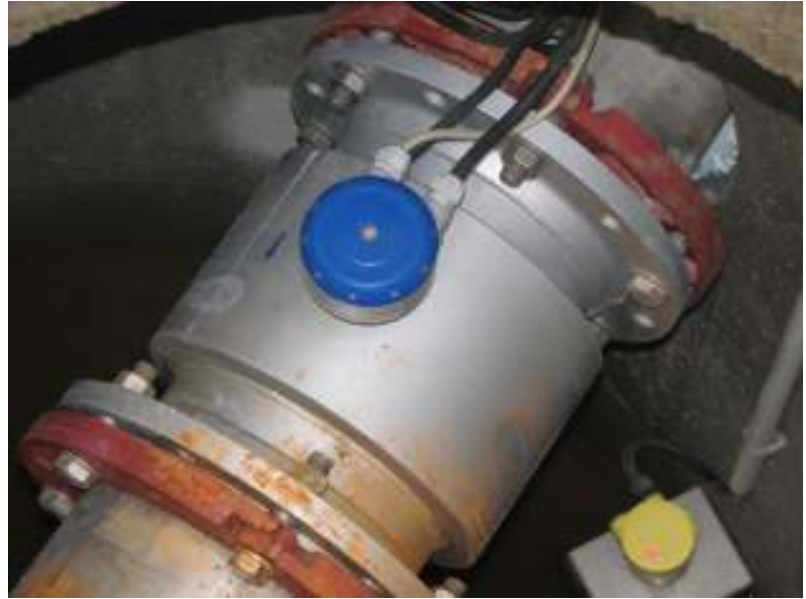
MID-Schacht mit OPTIFLUX Messwertempfänger und VEGASWING Piezoelektronische Messsonde; Bild 41
