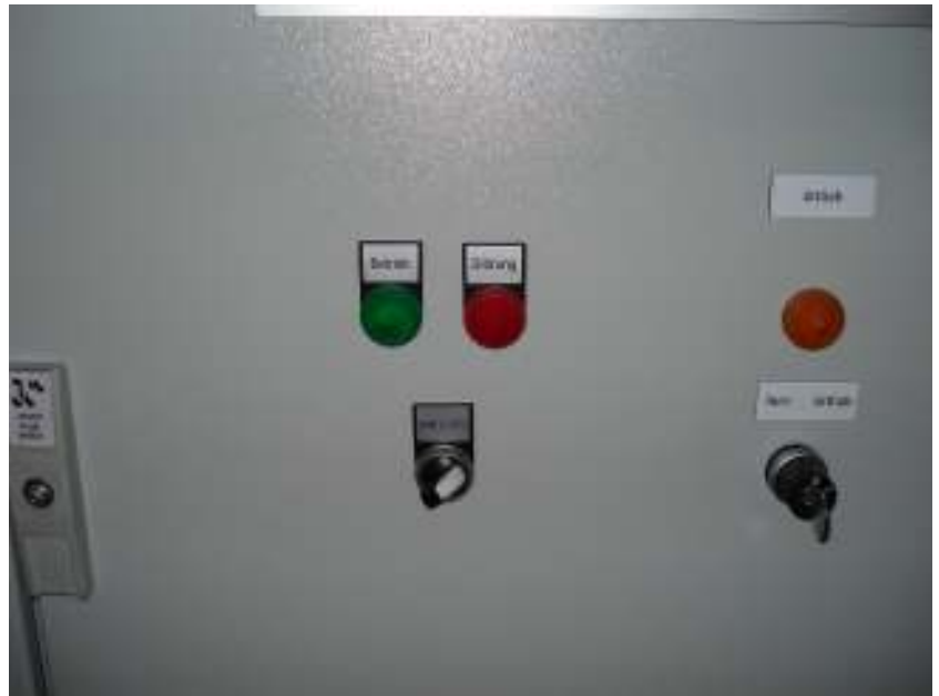
Bedienfeld Pumpe 1; Bild 38
