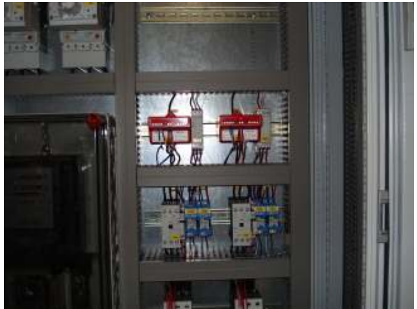
Schaltschrank rechtes oberes Schaltfeld; Bild 35
