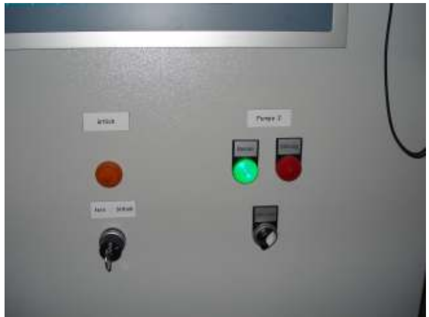
Bedienfeld Pumpe 2; Bild 40
