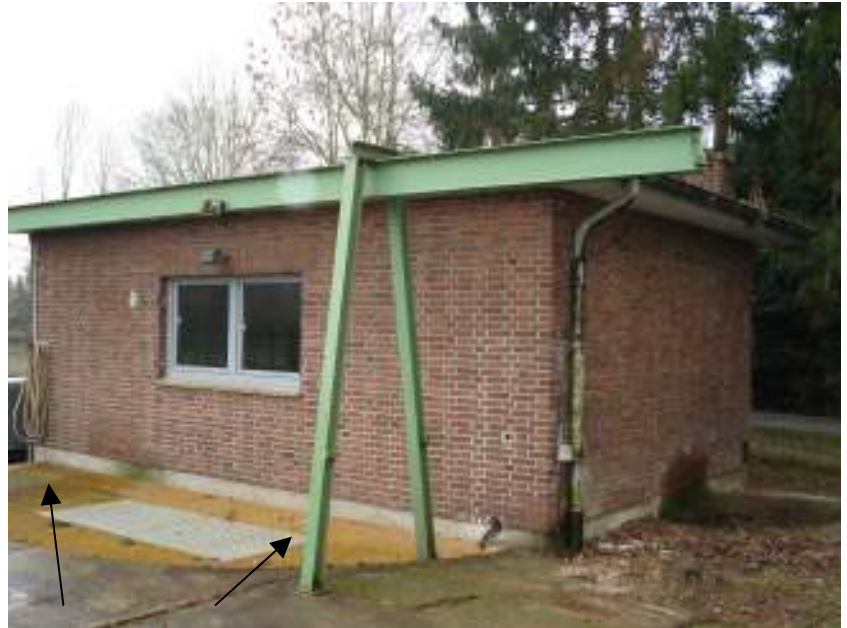
Pumpensumpf mit Betriebsgebäude; Bild 14
