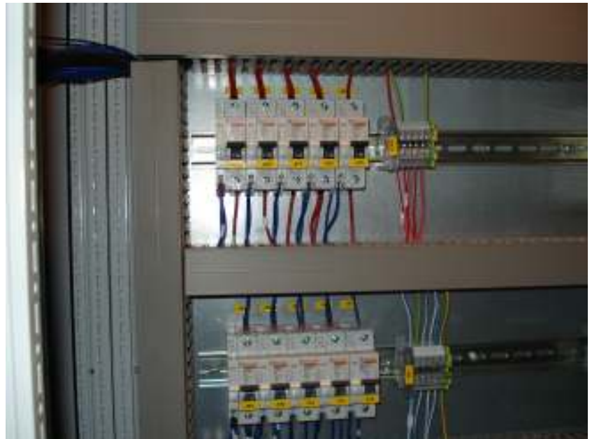
Schaltschrank, Sicherungsfield; Bild 07
