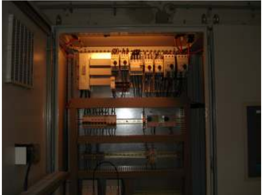
Schaltschrank linkes oberes Schaltfeld; Bild 33
