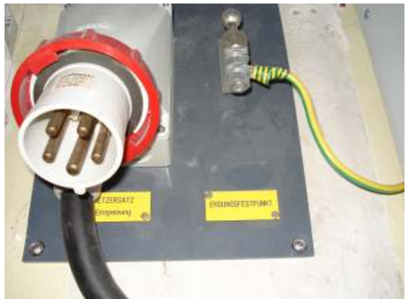
Notstromeinspeisung im Schaltschrank links; Bild 46
