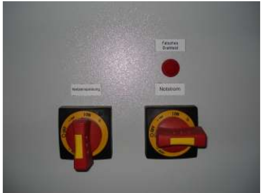
Wahlschalter zur Stromeinspeisung; Bild 05
