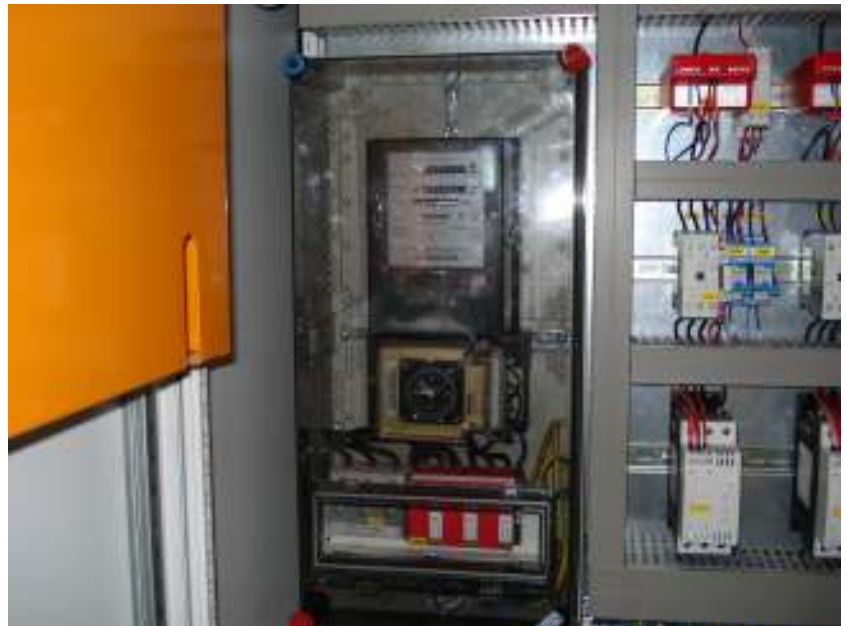
Wechselstromzähler und Zeitschaltuhr; Bild 04
